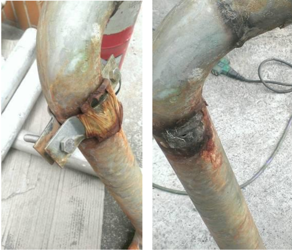
▲图 1-4：传统弯头环口焊缝处较易破裂 [1]
